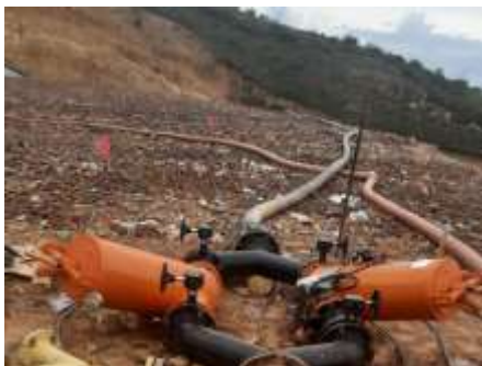
Fig. 6 Sistema de filtros conectados en paralelo.
