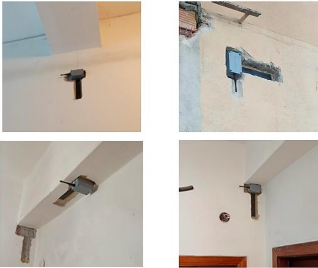
Fig. 5 Sensores instalados en un edificio existente (tomado de [15] , bajo licencia CC BY 4.0).
