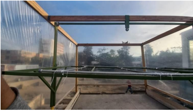
Fig. 8 Sistema de aspersión instalado
