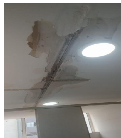
Fig. 10 – cumulo de agua en techo cerca de luminarias
