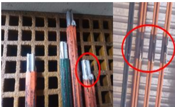
Fig. 5 Barras Eléctricas con presencia de sarro
