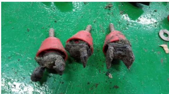
Fig. 4 Soporte de riel deteriorado
