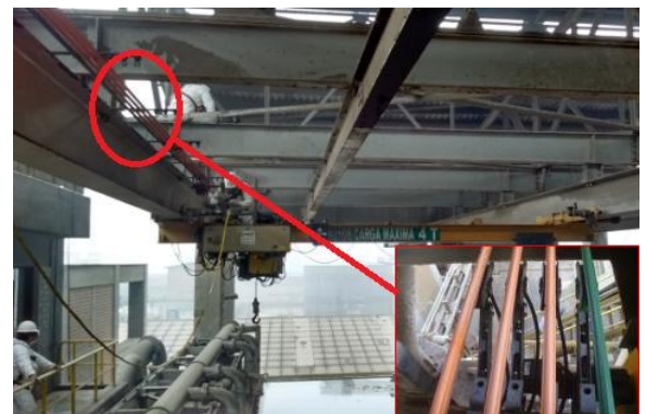
Fig. 2 Sistema de barras del puente grúa de lixiviación
