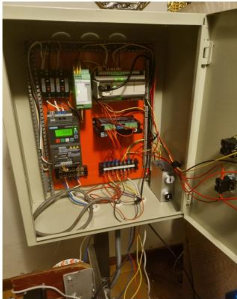
Fig. 16. Vista interna del tablero de control
