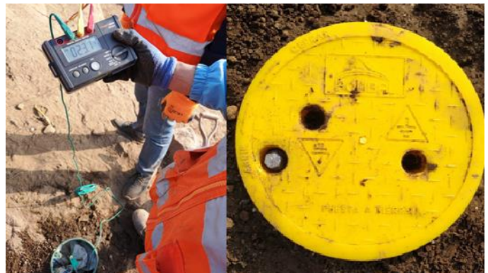
Fig. 15. Pozo a tierra para operación segura de electrobombas
