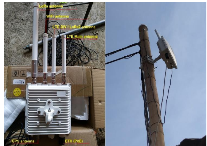
Fig. 18. Armado e instalación del gateway outdoor LoRaWAN
